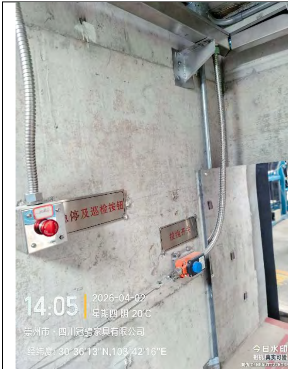
(a) 辐照室拉线开关（部分）
