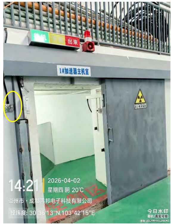
(d) 主机室防护门钥匙开关 (部分)
