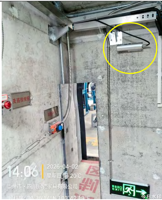
(a) 辐照室迷道内监测探头
