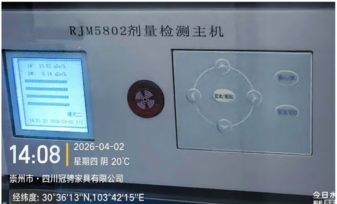
图 3-6-2 本项目固定式实时辐射剂量率监测系统（部分）
