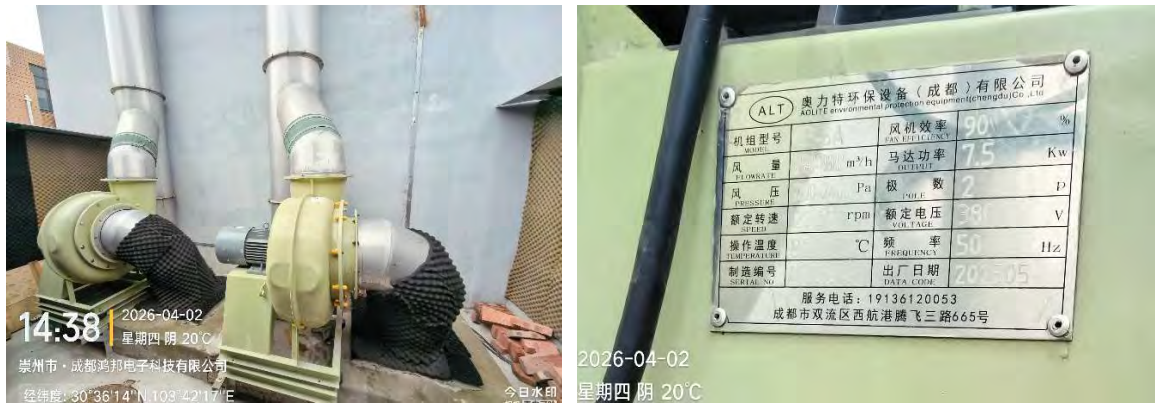
图 3-13-1 本项目工业电子加速器机房风机设备
