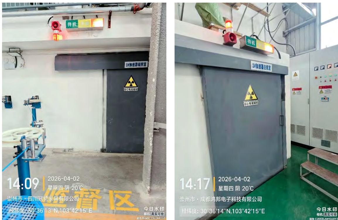
图 3-5 本项目 2#工业电子加速器机房当心电离辐射警示标志、工作状态指示灯及音响警示
