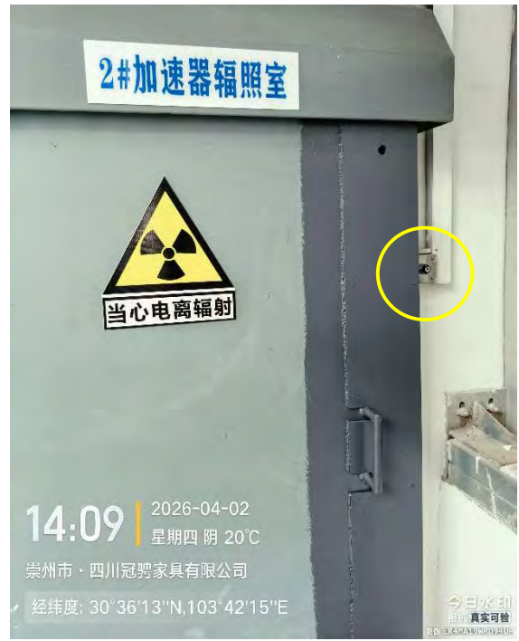
(b) 辐照室防护门钥匙开关 (部分)
