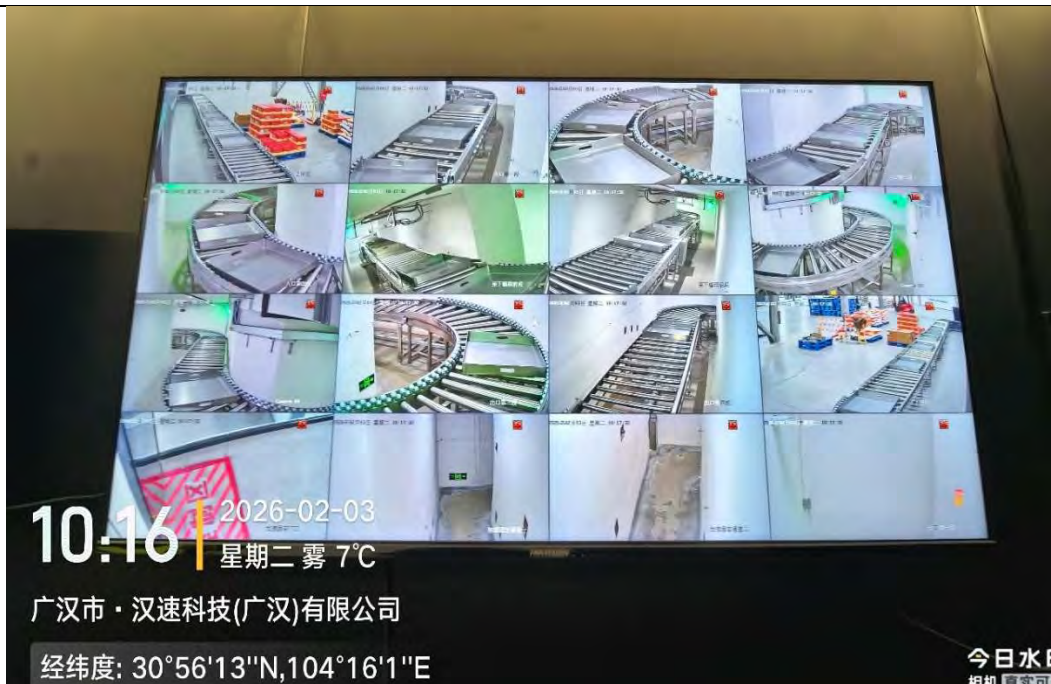
图 3-11-2 本项目工业电子加速器机房摄像监视系统
