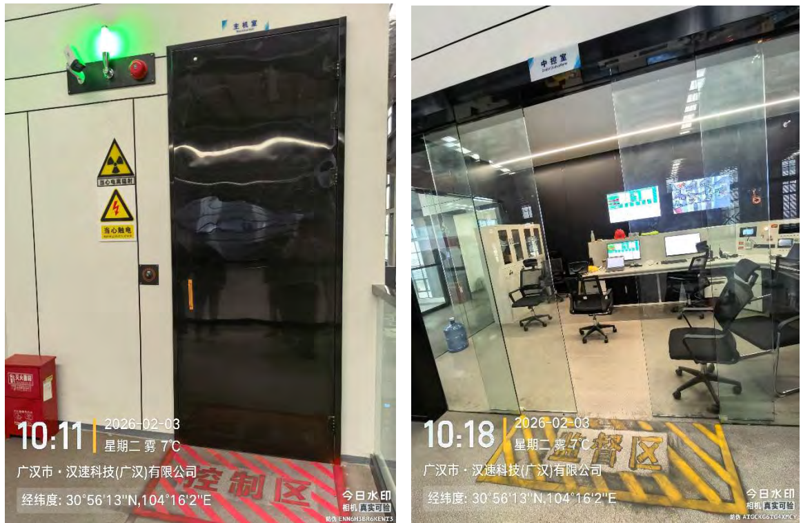
图 3-2-2 本项目工业电子加速器机房辐射防护分区现场照片（二层）
