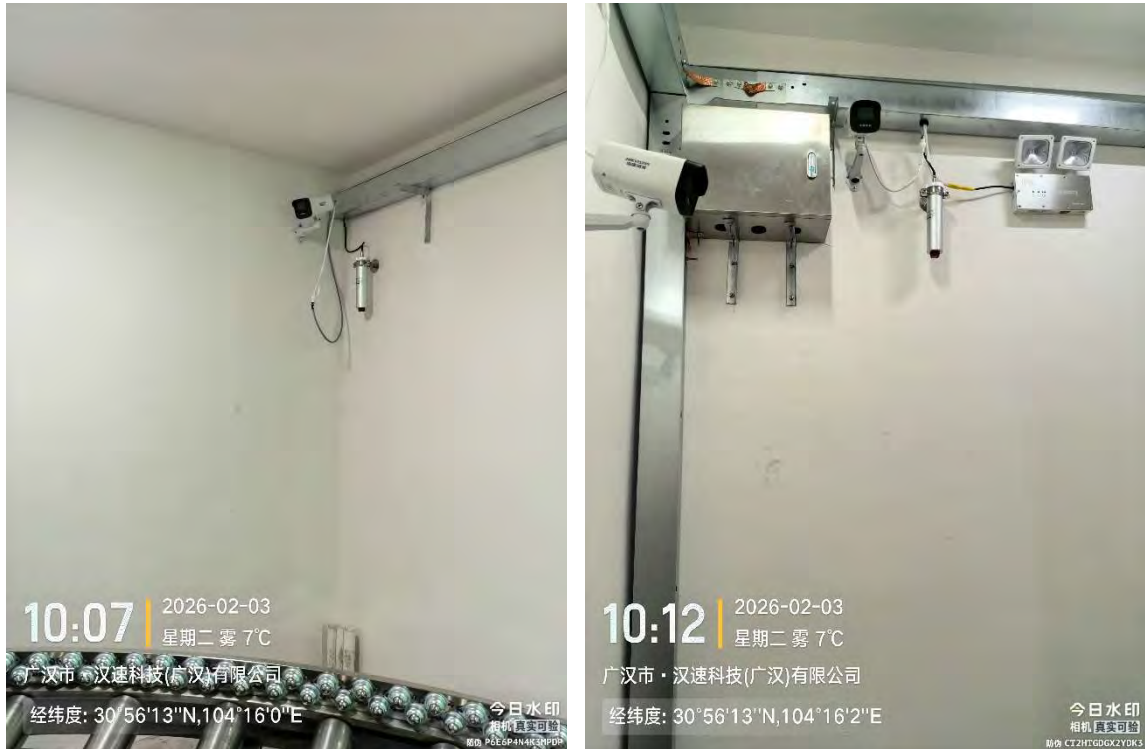
(a) 一层辐照室
