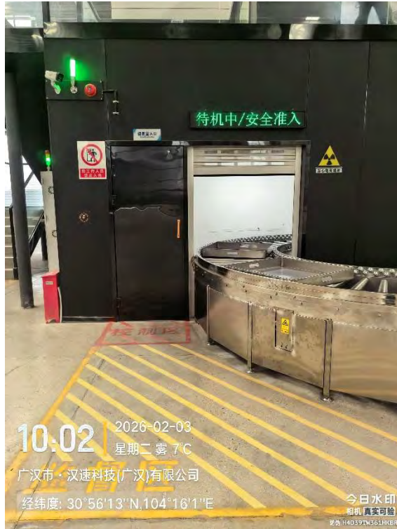
(a) 一层辐照室
