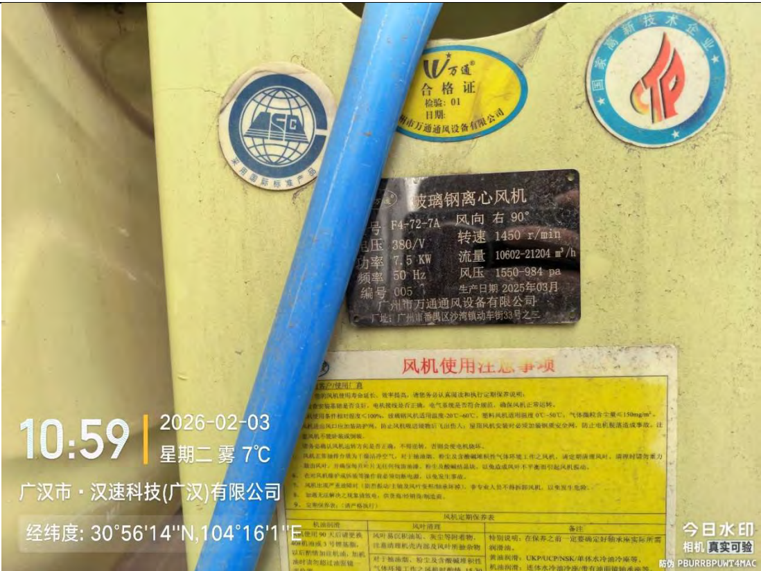
图 3-13-1 本项目工业电子加速器机房风机铭牌
