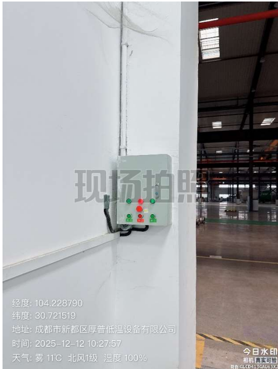
a. 工件进出防护门内紧急开门按钮
