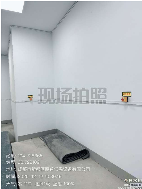
c. 工件进出防护门内紧急停机按钮
