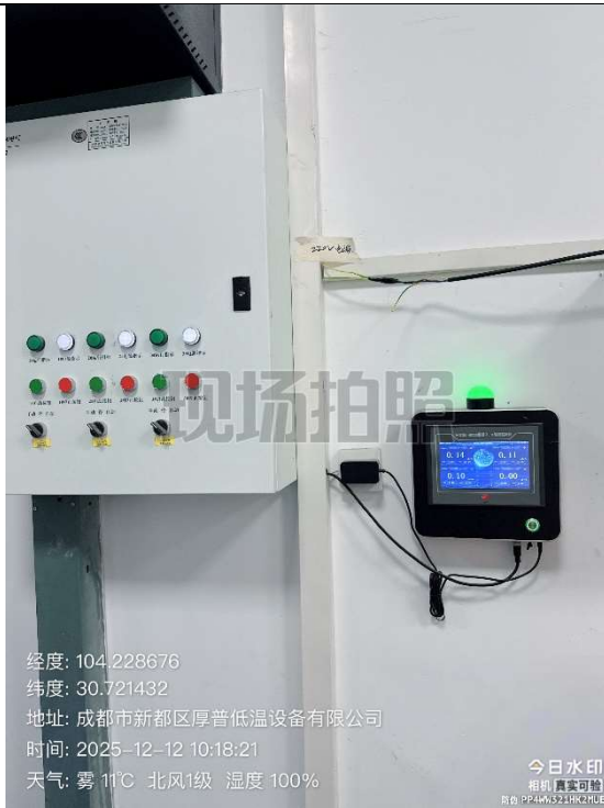
a.操作间内紧急停机按钮
