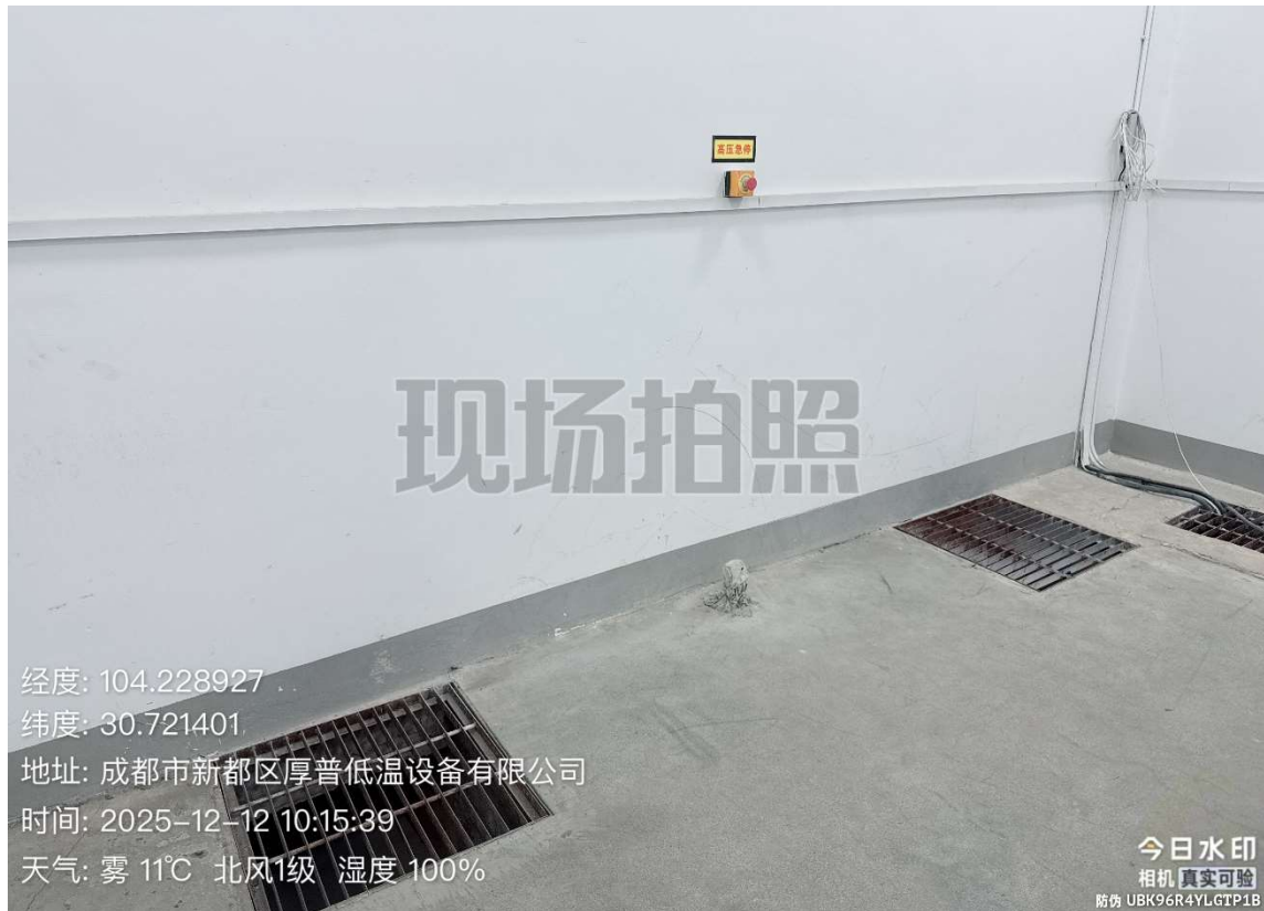
图 3-10 本项目曝光室通排风装置
