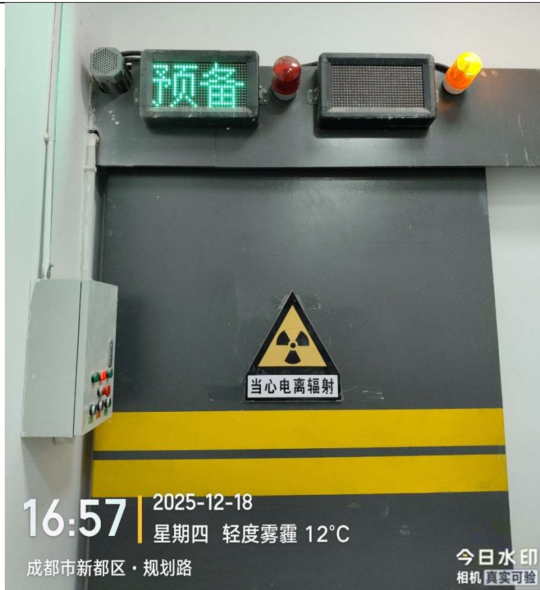
图 3-3-2 本项目曝光室迷道防护门当心电离辐射警示标志、工作状态指示灯（部分）
