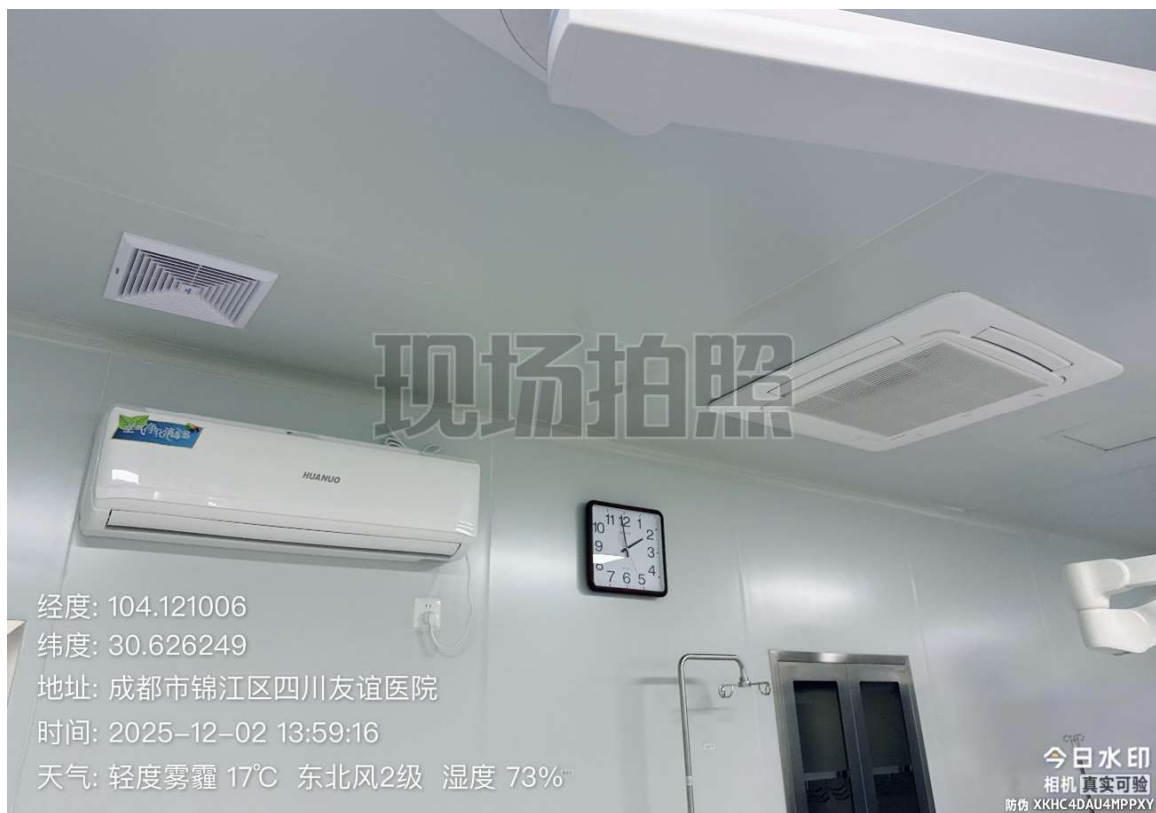
图 3-8 本项目 DSA 手术室通排风系统现场照片
