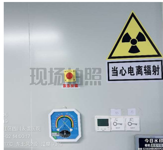
(c) 控制室内急停按钮
