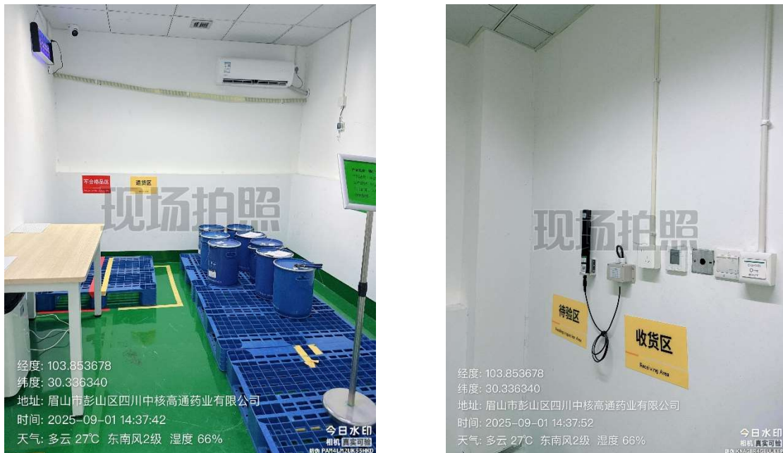
图 5-14 本项目放射性物质暂存间
