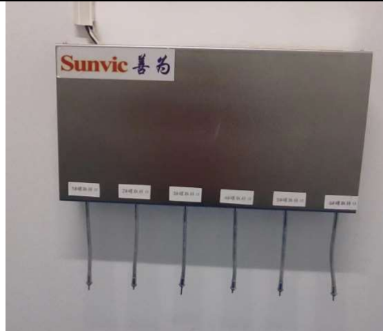
图 5-19 本项目放射性废液监测取样口
