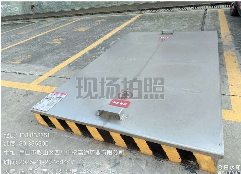
图 5-18 本项目废水收集池
