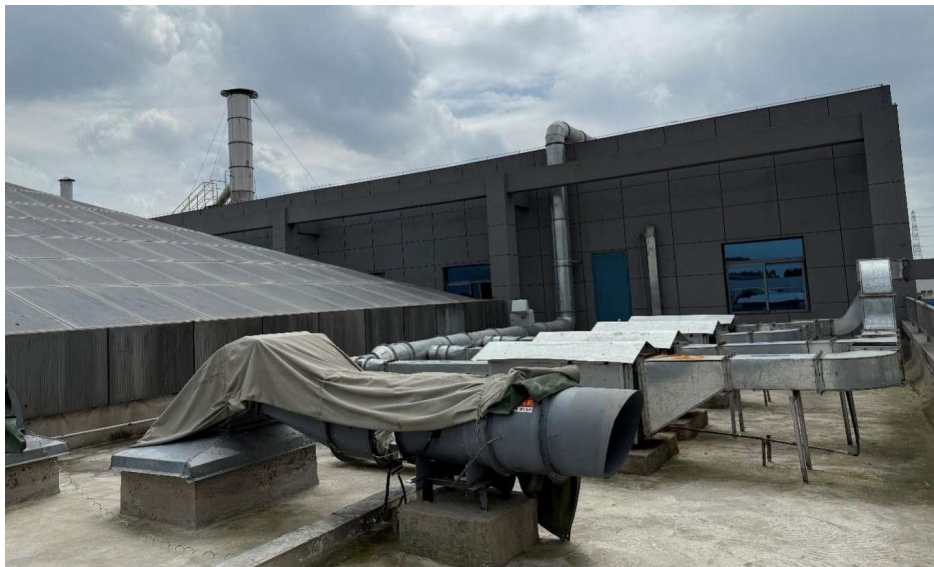
图 5-23 本项目废气排放口
