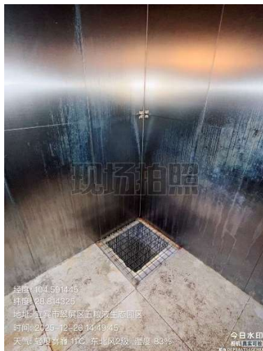
a.辐照室内排风口
