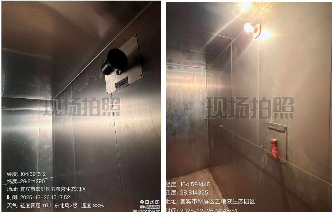
图 3-3 辐照室迷道内音响装置及警示灯（部分）
