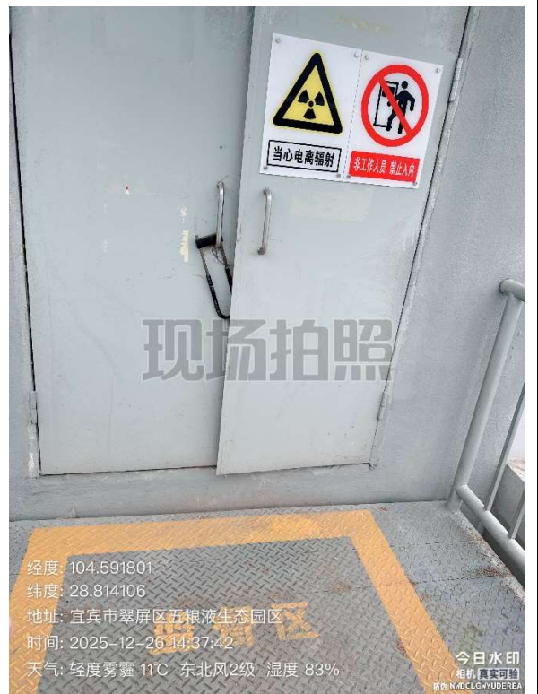
b) 2层设备间入口处
