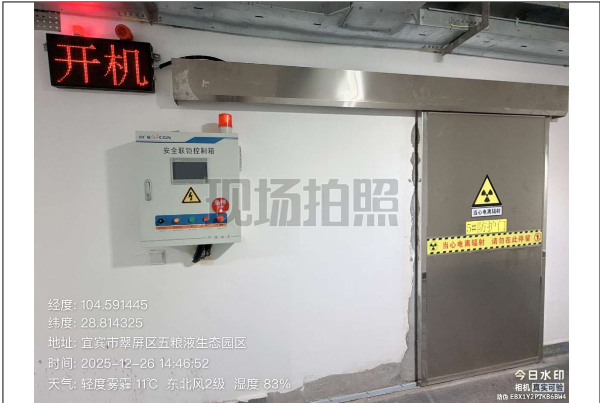
图 3-2 辐照室防护门当心电离辐射警示标志、工作状态指示灯及安全联锁等（部分）
