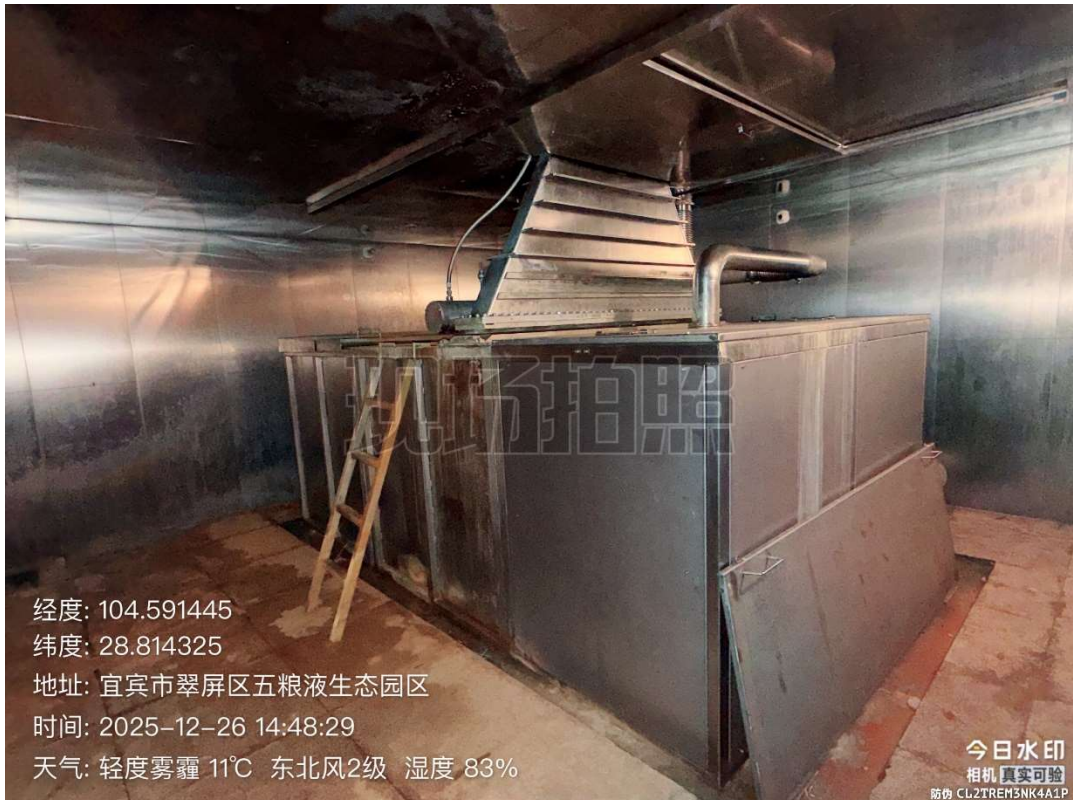
图 2-3-2 本项目 EP-DD LH 1.5-100-1650 型电子加速器实物外观图（一层辐照室）
