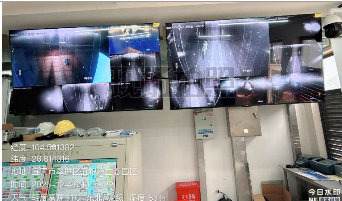
c.控制室实时监控画面
