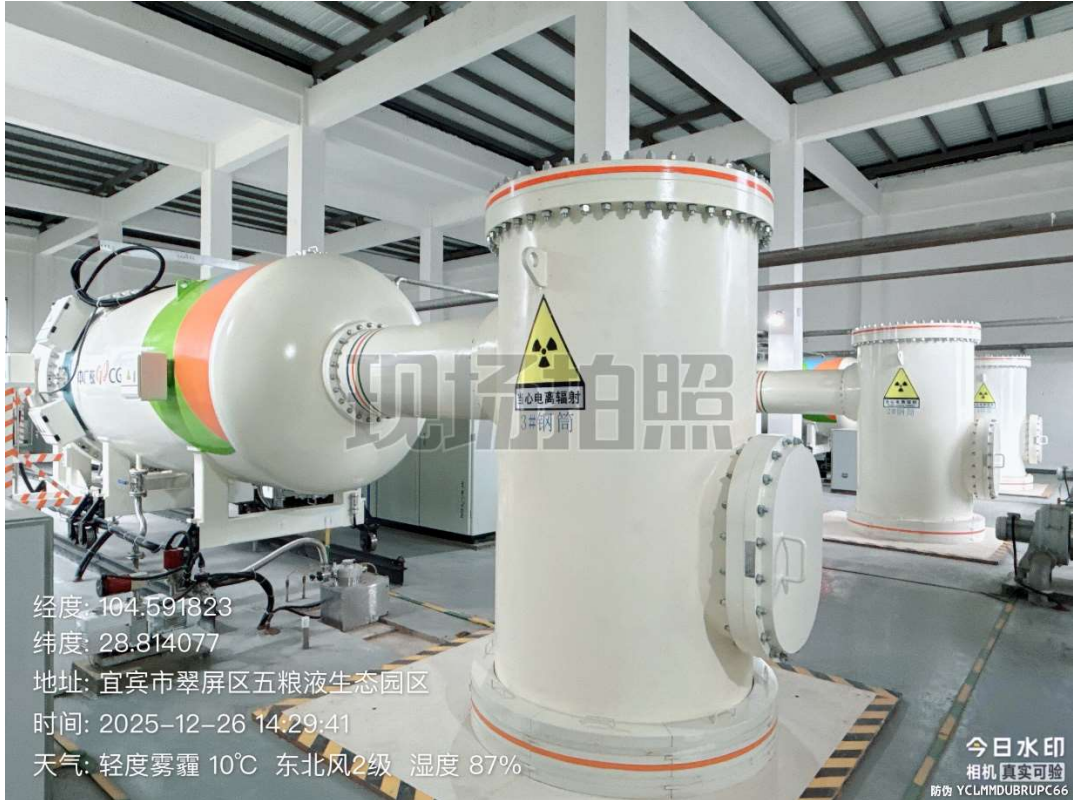
图 2-3-1 本项目 EP-DD LH 1.5-100-1650 型电子加速器实物外观图（二层设备间）
