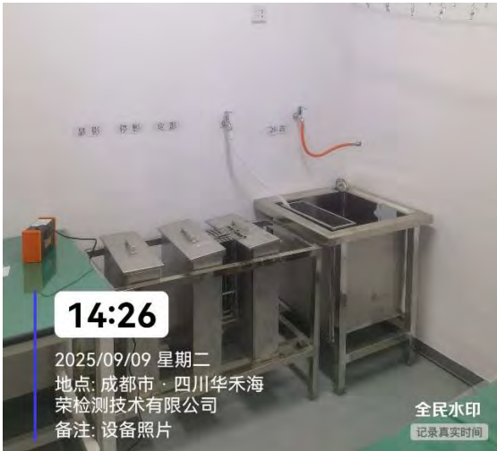
(a) 洗片室湿区
