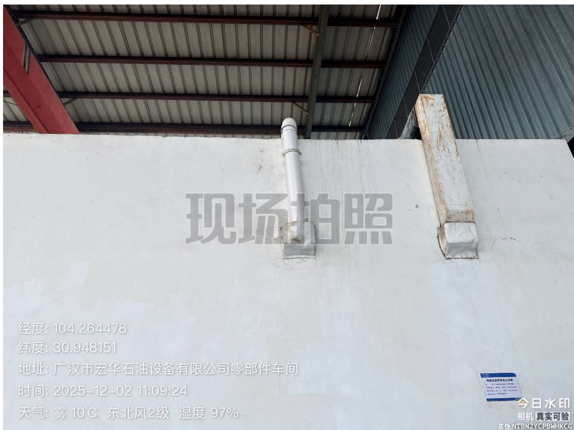
图 3-11 本项目探伤室通排风管道
